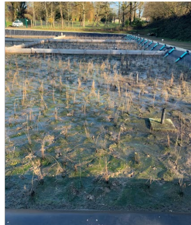
Après mise en service
